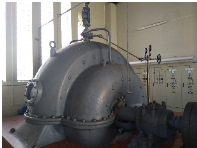
Abbildung 32: Historische Pumpe im Schöpfwerk Steinschleuse/Alte Sorge/Eider. Quelle: P. Krahe, BfG
