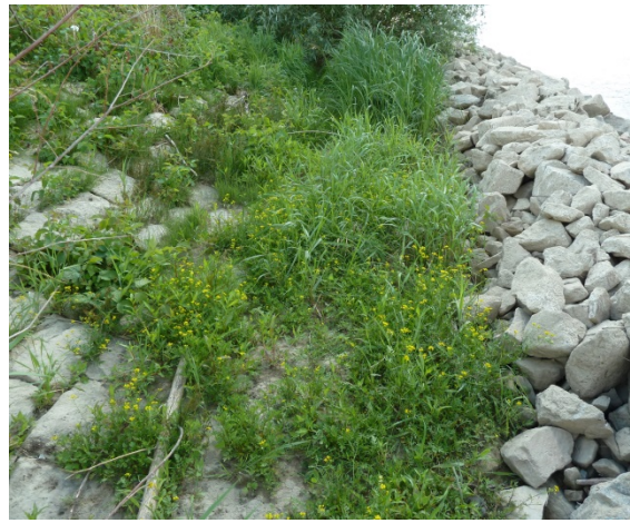
Bild 26: Pflanzlicher Bewuchs auf Schlammablagerungen hinter Steinwall (13.8.2013)
