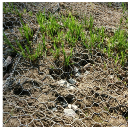
Bild 10: Lokale Schäden an den Gabionen im VF 5a (15.7.2013)
