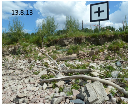
Bild 18: Erosion an der Böschungsschulter
