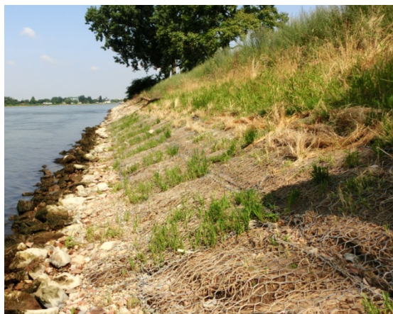
Bild 9: Röhrichtgabionen (VF 5a) nach andauerndem Überstau (15.7.2013)
