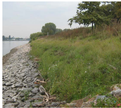
Bild 16: Vegetationsentwicklung nach Sanierung im VF 7a oben (4.10.2013)
