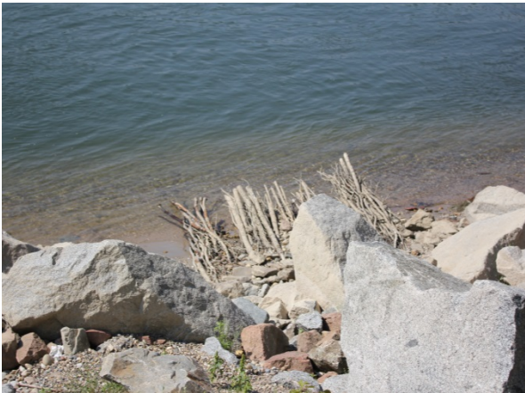
Bild 21: Erodierter Feinmaterial im Bereich der Totholzfaschinen (26.8.2013)
