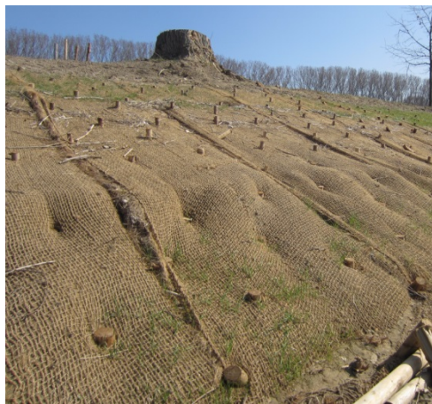
Bild 15: Böschungsverformungen nach Überstau im VF 7a oben (22.3.2012)
