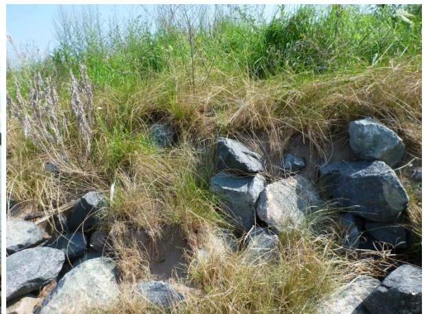
Bild 24: Reste der Grasnarbe im oberen Böschungsbereich (15.7.2013)
