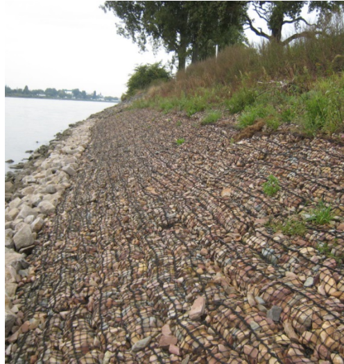
Bild 12: Steinmatratzen (VF 5b) nach Rückbau der Pflanzmatten (4.10.2013)
