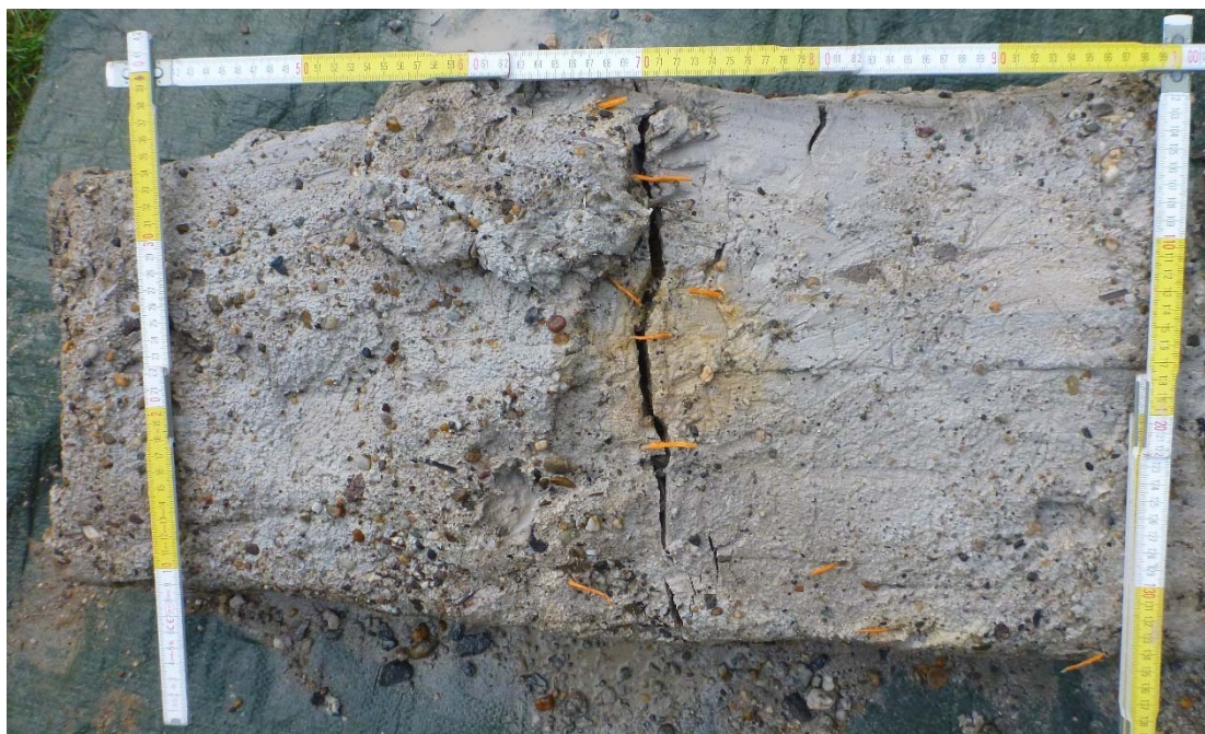
Abbildung 3-15: Horizontalschnitt in 15-20 cm Dichtungstiefe mit orangefarbig markierten Wurzeln, die in größere Tiefen der Dichtung eindringen. Die Steine im Ton sind Verunreinigungen, die beim Transport des Tonblocks in den Ton gedrückt wurden. Der Riss ist bei der Untersuchung des Blocks entstanden und steht nicht im Zusammenhang mit der Häufung von Wurzeln in diesem Bereich.
