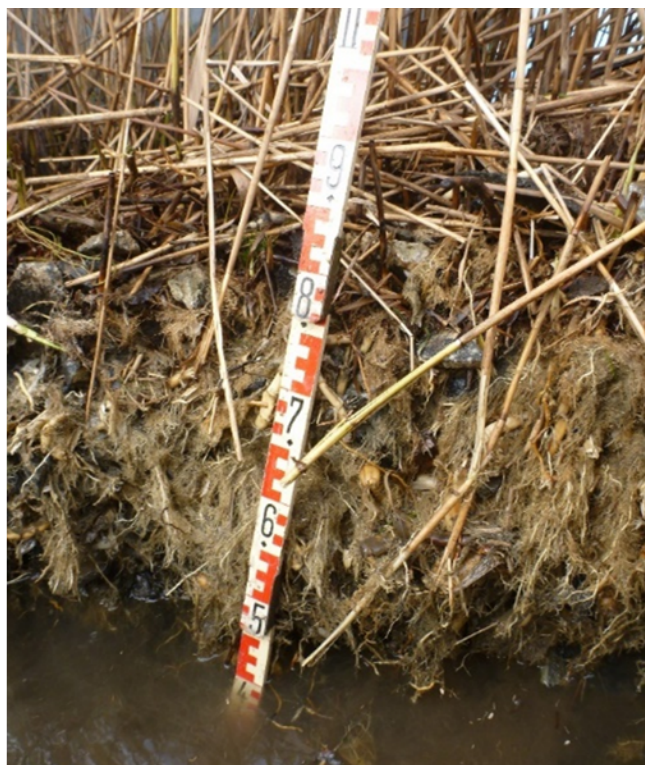
Abbildung 3-10: Durchwurzelung der oberen 35 cm des Deckwerks am Günthersdorfer-Damm, die Profilmessschiebe liegt etwas oberhalb des Niveaus des Betriebswasserstands
